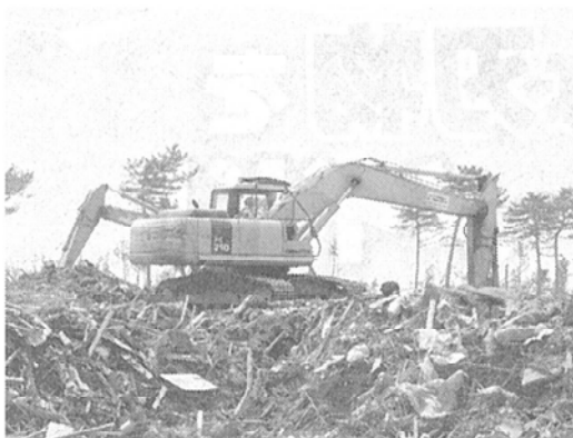
建廃に性状が近い災害廃棄物
